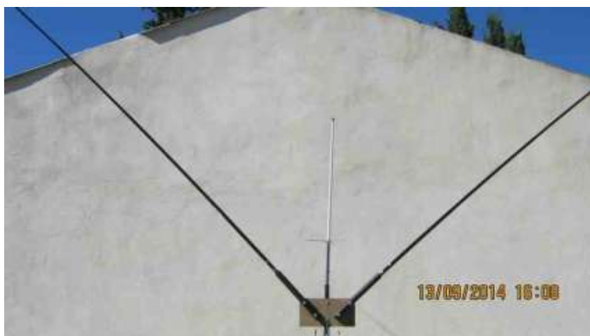
VUE D'UNE ANTENNE BI-BANDES VHF-UHF INSTALLEE AU MILIEU DE L'ANTENNE EN « V »
